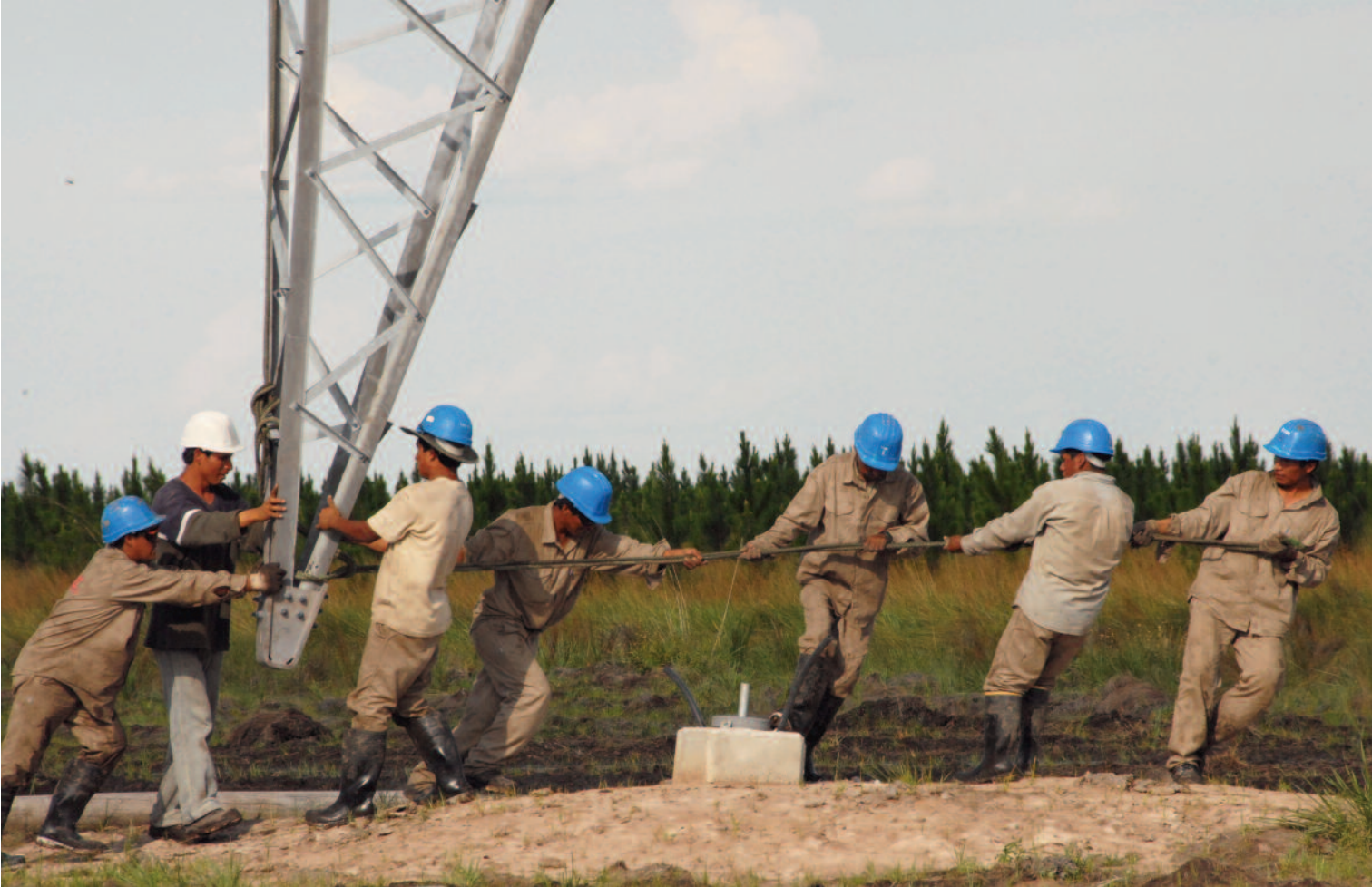
Líneas de alta tensión.
